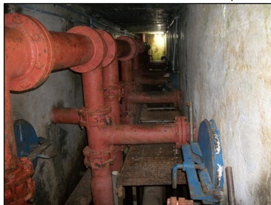
Tanques de lavado de los Filtros de la PTAP del Municipio de Cimitarra
