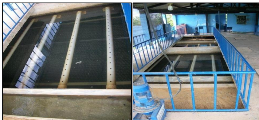
Figura 8. Sedimentadores de la PTAP del Municipio de Cimitarra
