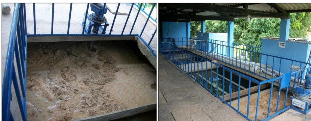
Figura. Floculadores de la PTAP del Municipio de Cimitarra
